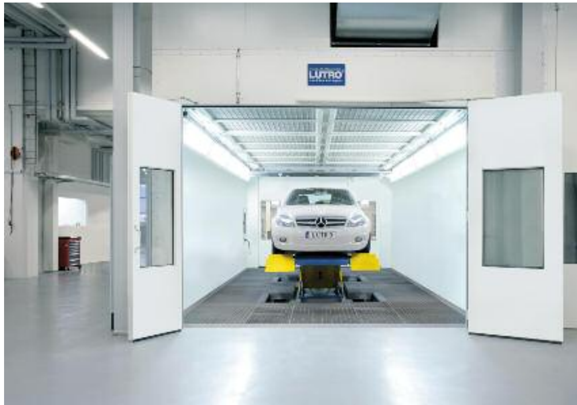
Farbspritzkabine mit integrierter Hebebühne und Durchfahrtmöglichkeit
