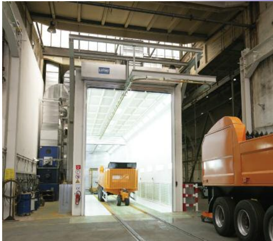
Kombinierte Farbspritz- und Trockenkabine für die Nutzfahrzeuglackierung mit in Längsrichtung anschließender Reinigungskabine. Die Kabinen sind durch ein Rolltor unterteilt. Für die Teilereinigung und Lackierung ist eine Hängebahn in die Kabinenkonstruktion integriert.
