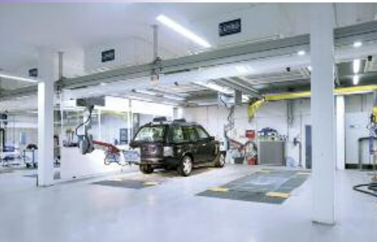
Vorbildlich eingerichtete Vorbereitungsplätze mit Zu- und Abluft, Hebebühnen und IR-Trockner.
