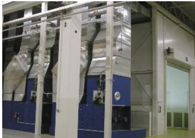
Aggregateinheiten mit Gasflächenbrenner und Wärmerückgewinnung.
