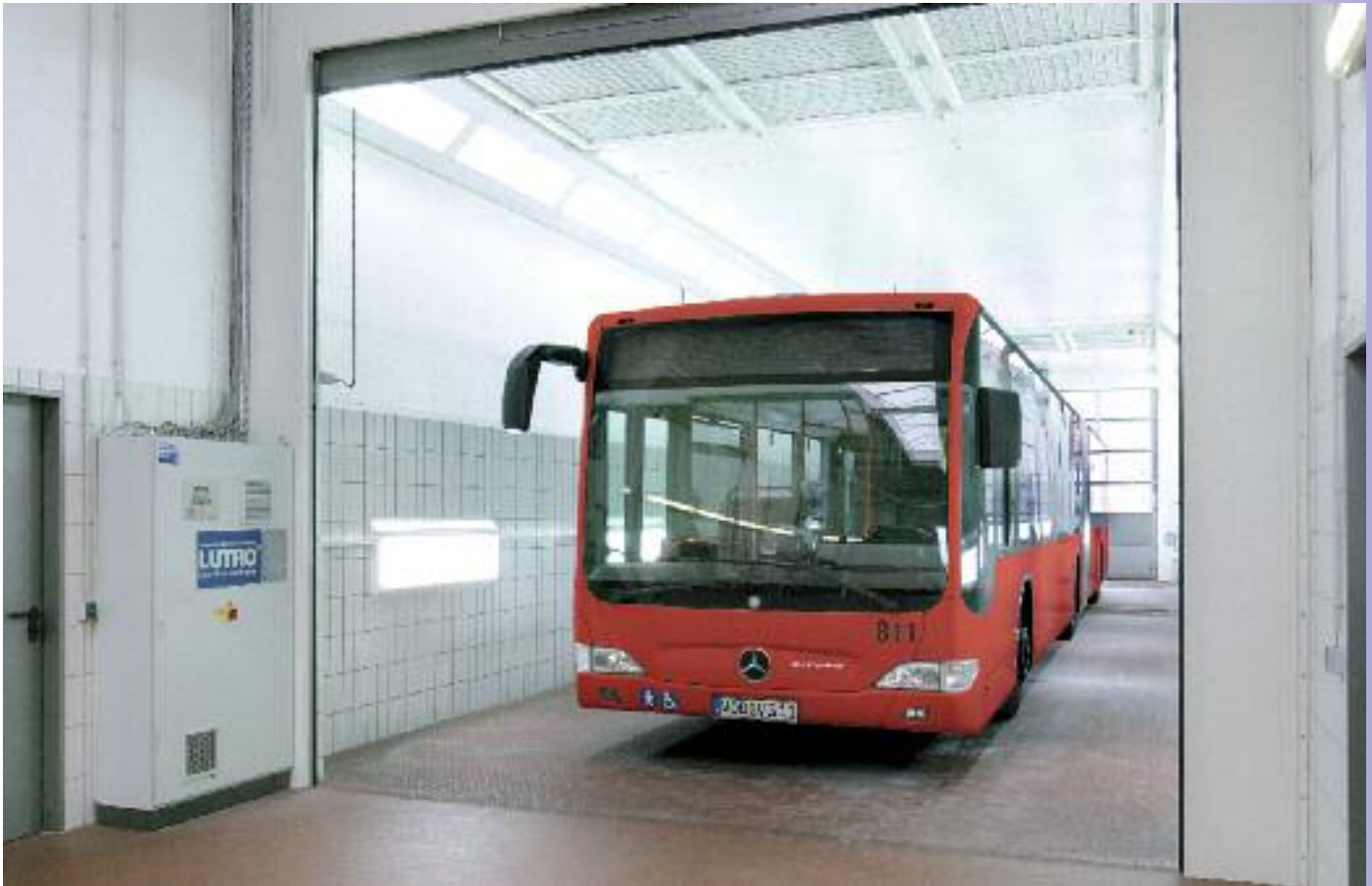
Kombinierte Farbspritz- und Trockenkabine für die Nutzfahrzeu lackierung.
